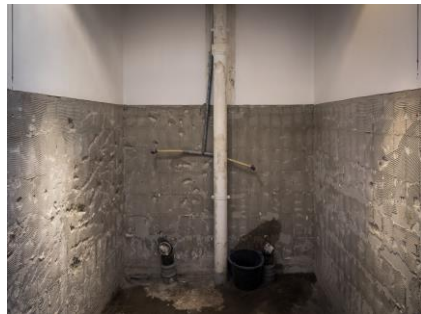
Die entkernte Damentoilette
